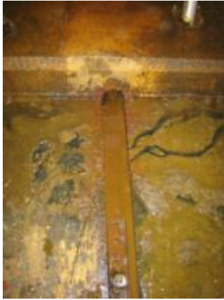
KUVIO 31 Lantakäytävän kuivana pysymiseksi virtsanerottelukourut tai -luukut tulee olla puhtaat, jotta virtsa valuu lattialta pois.
